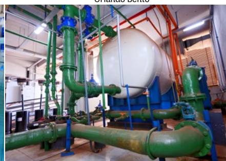
ETA – Estação de Tratamento de Água do Minas Náutico
