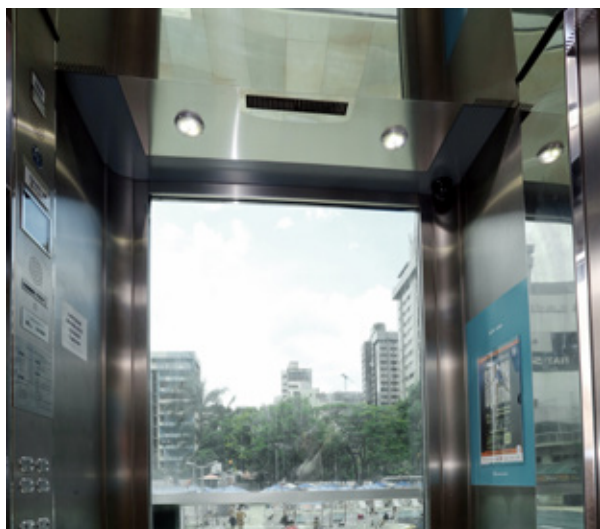
Elevador panorâmico na Unidade I é parte do circuito de manutenções preventivas realizada pelo CCO
